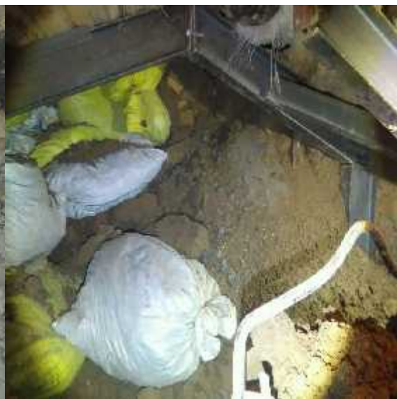
۱۷- ریزش متعدد محل حفاری
