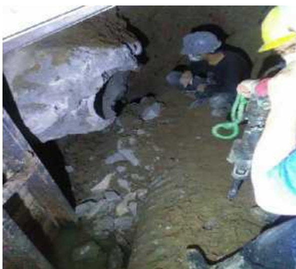
۲۱-تخریب لوله ۵۰۰ میلیمتر
