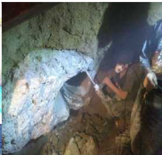
۲۰-تخریب بتن حجیم اطراف لوله ۵۰۰ میلیمتر
